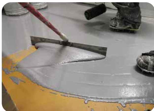
Распределение цементно-полиуретанового покрытия ДенсТоп ПМ 605 Флоу при помощи ракли с регулируемым зазором
